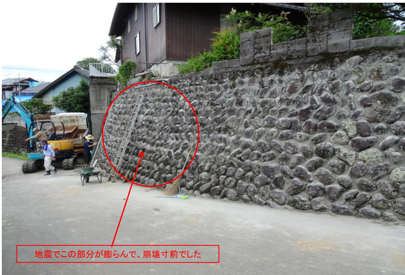
石積擁壁の目地補強 既に地元の方5人で作業をしていたが、午後からボラ10人が合流 15:26 補強作業完了 梅雨前の対応が必要でした
